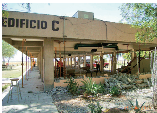
修理しても修理して直らない建物。2010年4月のメヒカリ地震で半壊扱いとなった講義棟の2ヵ月後のようす。予算の名目上「建替え」ということができず、あくまで補修、補強工事の名目でしかお金が下りないらしい。過去の地震でも3度ほど補修されたこの建物も、今回はついに躯体だけになった挙句、結局取り壊し、予算もつかずにその後1年以上更地となっている。「過去18回にわたって雨漏り補修工事を繰り返すも、いまだに雨漏りしつづけている建物」なんていうのも存在する。
